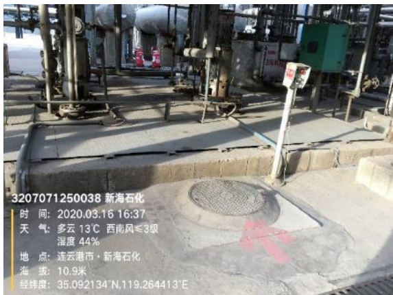
污水或污油地下输送管线
