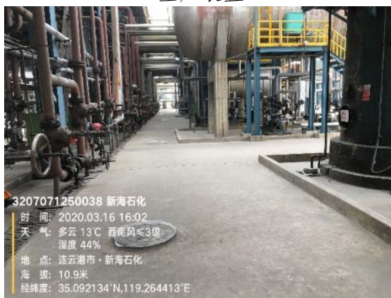
污水或污油地下输送管线
