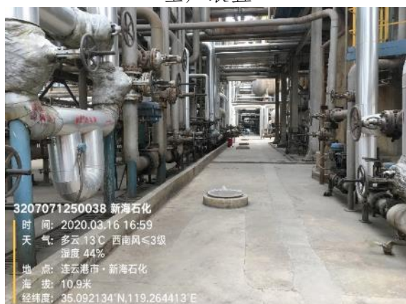
污水或污油地下输送管线
