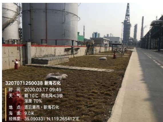
污水或污油地下输送管线
