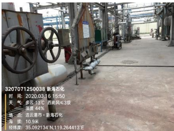
污水或污油地下输送管线
