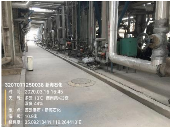
污水或污油地下输送管线
