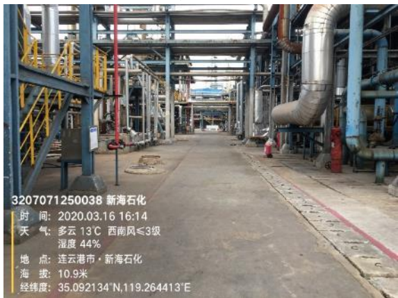
污水或污油地下输送管线
